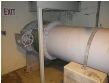
Biotower effluent pipe
